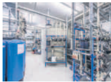
Blick in die moderne Abklinganlage der Klinik Dr. Hancken: Hier werden die Abwässer der Isotopen-Station geklärt und bis zur Entsorgung gespeichert.
