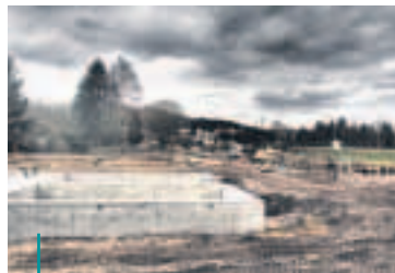
Auf der ehemaligen Pferdewiese am Bostenbeker Bogen wird bereits gebaut. Hier entsteht eine Wohnunterkunft für 168 Menschen.
