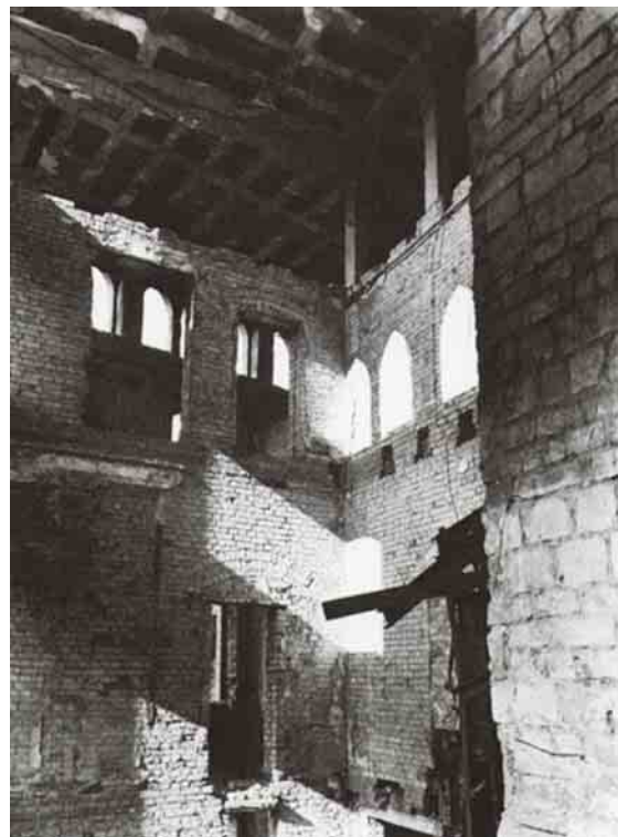
Abb. 18 Das zerstörte Innere.
