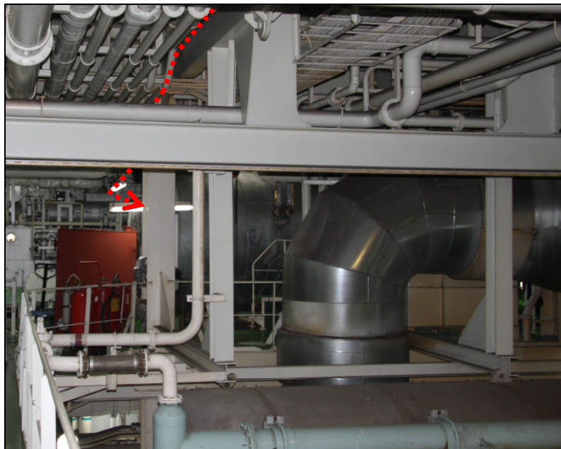
Abbildung 5: oberer Bereich des Maschinenraums in Schiffsquerrichtung 6
