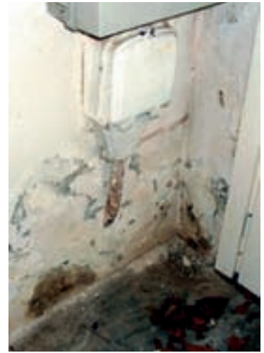
Feuchte Kellerecken sind ein häufiges Problem
