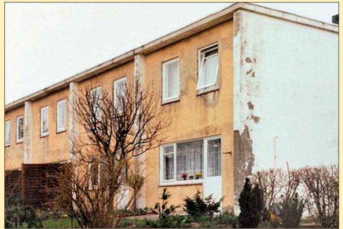
Die Bausubstanz (1985) war durch die zwanzigjährige Misswirtschaft der Neuen Heimat sehr heruntergekommen. Auch während des Konkursverfahrens und der Jahre danach war nichts für den Unterhalt der Gebäude getan worden.
