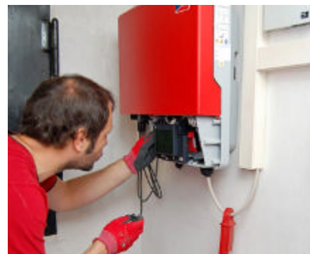
Gebündelte Technik: Neben der gesamten Heiztechnik befinden sich im Technikraum des Hauses der Familie Daiber auch Wechselrichter und Komponenten für die Verteilung des Stroms aus der Photovoltaikanlage.
