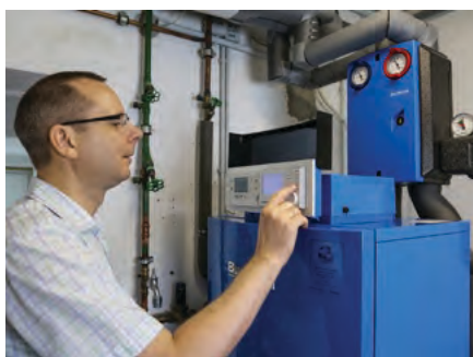
Optimale Wärmelösung: Thomas Deickert checkt die Einstellungsdaten seines Öl-Brennwertgeräts.
