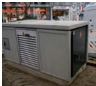
Einer der neuen Verteilerkästen
