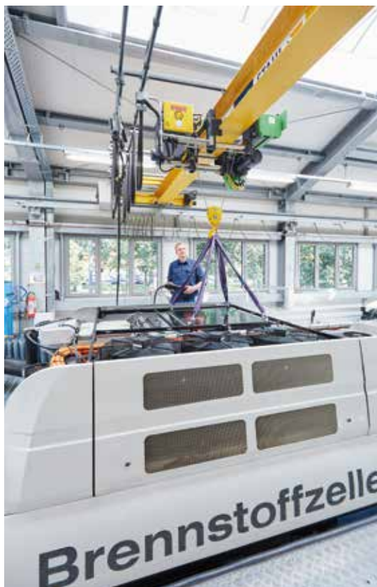
Abbildung 4/12: Fest installierter Kran auf dem Dacharbeitsstand
