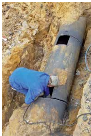
Ein altes Gasrohr wurde bei den Bauarbeiten im Boden gefunden und musste entfernt werden. Bild: SBI
