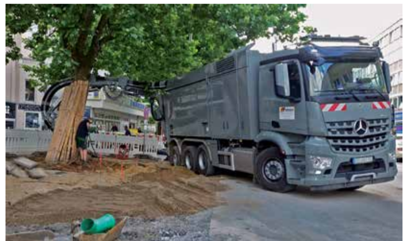
Eine defekte Wasserleitung ist geplatzt: Das ausströmende Wasser hat einen Baum unterspült, der daraufhin gesichert werden musste. Bild: SBI
