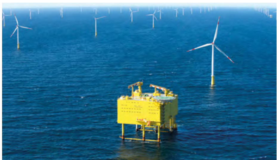
An den Konverterplattformen wird der Windstrom umgewandelt
