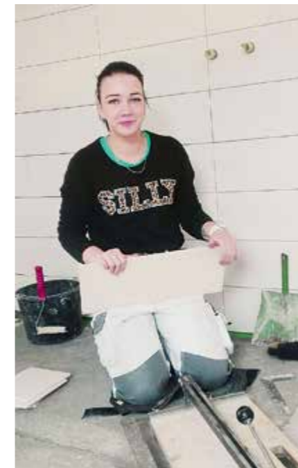
Selbst ist die Frau: Andra war zwar auf vielen Baustellen die einzige Frau, aber verlegte die Fliesen genauso gut.
