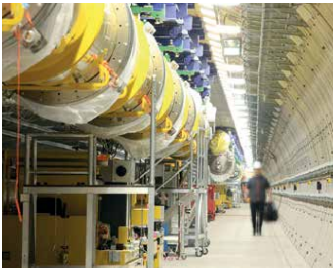
Beschleunigtunnel 2 XFEL · Foto: DESY 2015
