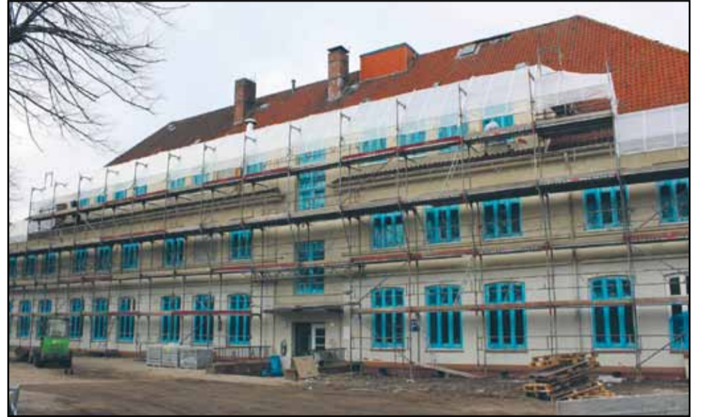
77 Plätze für die Erstversorgung von unbegleiteten minderjährigen Flüchtlingen bietet die EVE 16 im Tannenweg. Im April wird sie in Betrieb genommen. Das Gebäude, eine ehemalige Schule, wurde für diesen Zweck umgebaut. Fotos (3): Bormann
