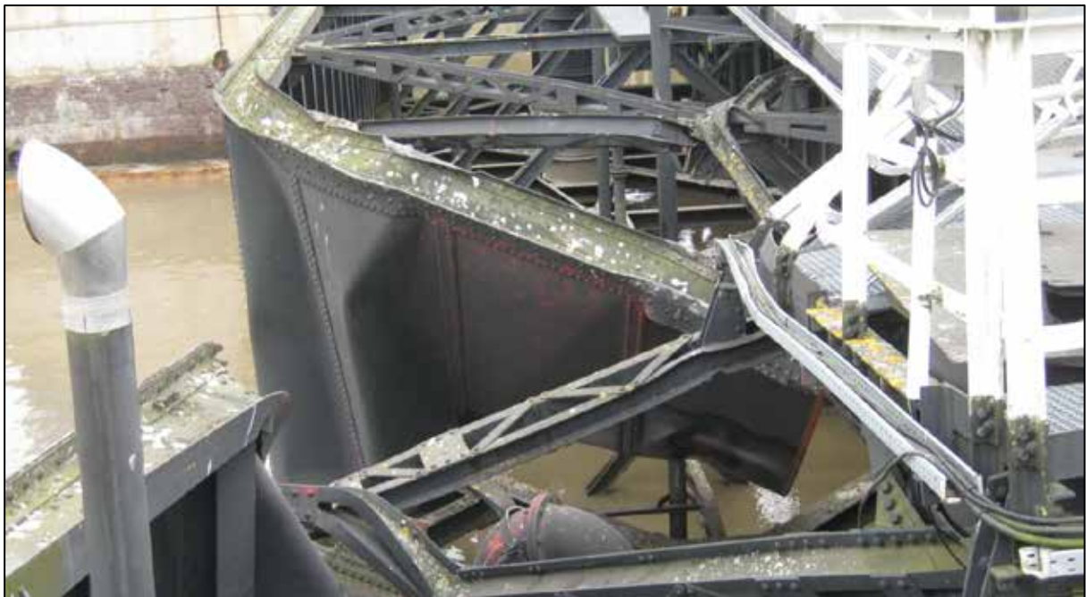
Abbildung 6: Schaden am Schleusentor
