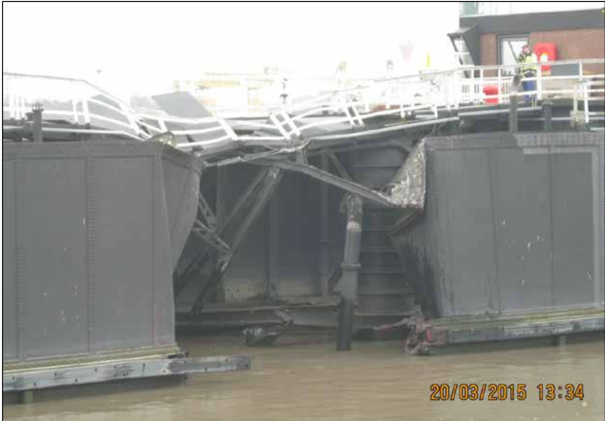
Abbildung 5: Schaden am Schleusentor
