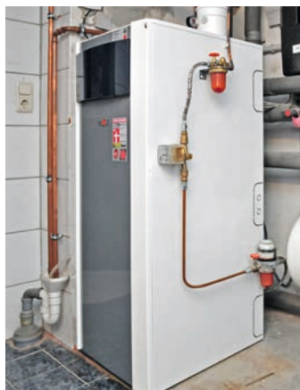
Hybrid: Neue Öl-Brennwerttechnik kombiniert mit Solarthermie und Scheitholzkessel sichern die Wärmeversorgung.
