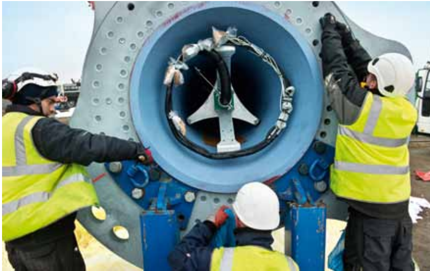
DIE NABE DES WINDRADES AUF GEORGSWERDER KURZ VOR DER MONTAGE: DAMIT ES HIER AUF DAUER RUND LÄUFT, MUSS JEDE SCHRAUBE SITZEN.
