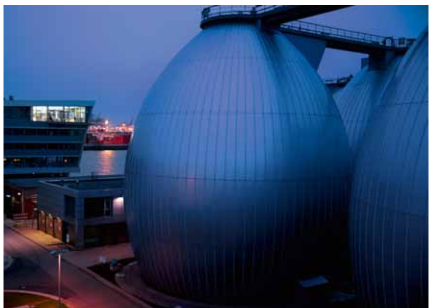
AUS SCHLAMM WIRD GAS: IN DEN FAULTÜRME WIRD KLÄRSCHLAMM IN STÄDTISCHES BIOMETHAN UMGEWANDELT.
