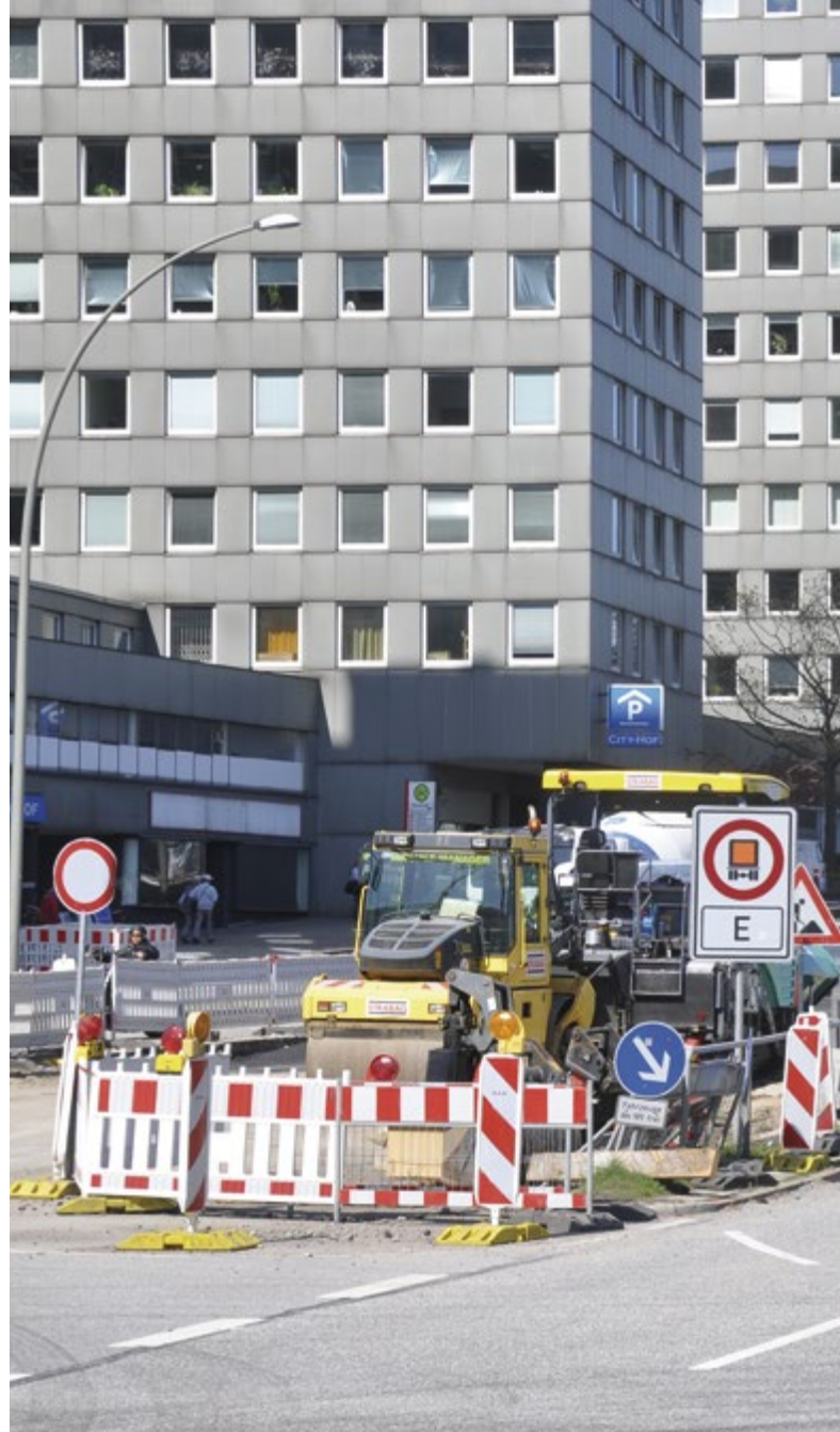
Auf guten Weg: Die Sanierung des 50 Jahre alten Wallringtunnels. Foto: F. List.
