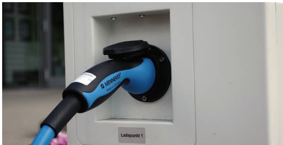
Stromtankstelle bei der MVK.
