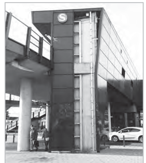
Selbst der S-Bahnhof Wilhelmsburg wurde nicht - wie geplant - zur igs fertig und fällt jetzt, nach zwei Jahren (!), schon wieder auseinander. Hätte es mit den Riesenbauten für Olympia geklappt? Die Olympiagegner waren nicht mutlos, sondern aus Erfahrung klug. Bild Jan Groß
