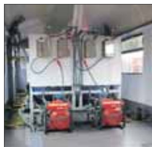
Generatoren betreiben die Sprühdüsen für den Wasserstrahl.
