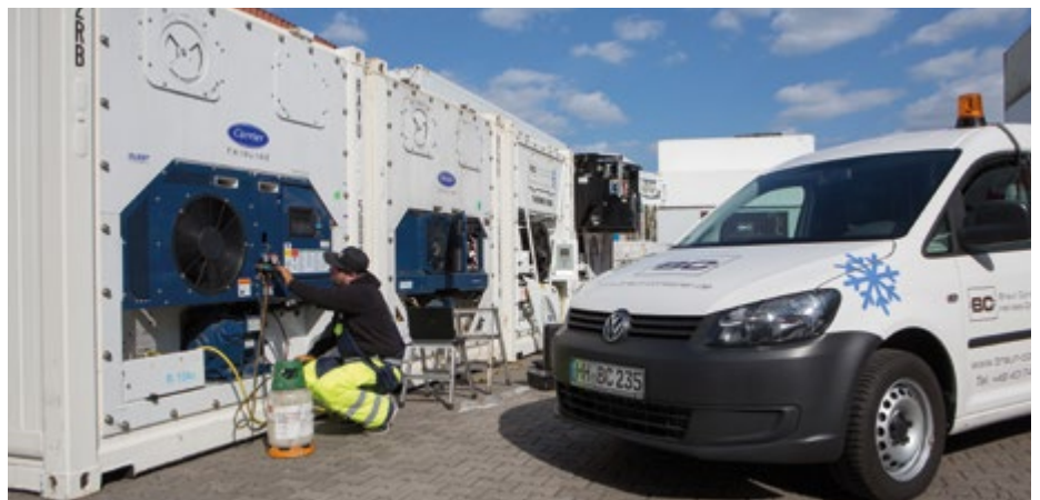
Die Reparatur von Kühlaggregaten gehört zum Alltagsgeschäft
