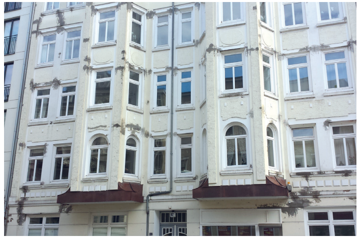
An der Fassade des Altbaus in der Erikastraße 80 haben sich Risse gebildet. Eppendorfer fragen sich, ob diese vom benachbarten Neubau rühren.
