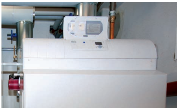
Moderne Heiztechnik für die VE 8, Försterweg 1 – 9 und Kieler Straße 241 – 245 in Stellingen: neue Pumpen, eine hydraulischen Weiche, die für das richtige Verhältnis zwischen Warm- und Kaltwasser sorgt sowie einer von zwei neuen Heizkesseln in Gas-Brennwerttechnik.
