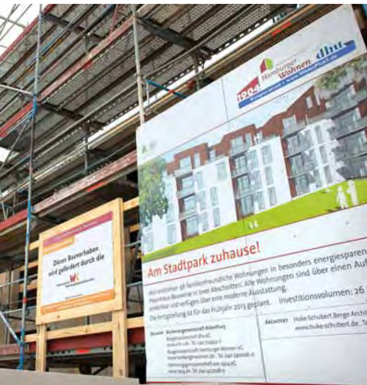
Zu keiner Zeit besser sichtbar: Der Baufortschritt unseres Neubauprojektes „Am Stadtpark zuhause“ während der Rohbauarbeiten
