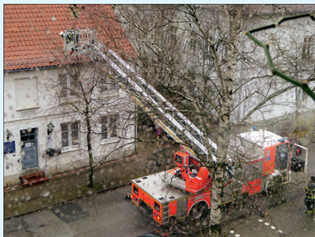
Orkan »Niklas« deckte einige Schindeln vom Dach des Heimatmuseums ab, die von der Feuerwehr geborgen wurden.
