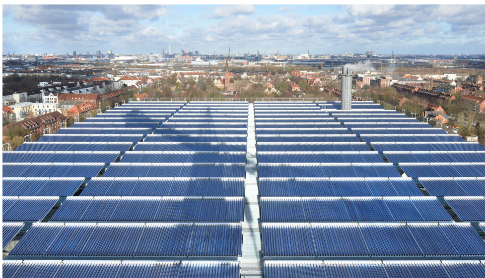
Abb. 7: Das CPC-Vakuümrohren-Kollektorfeld auf dem Dach
