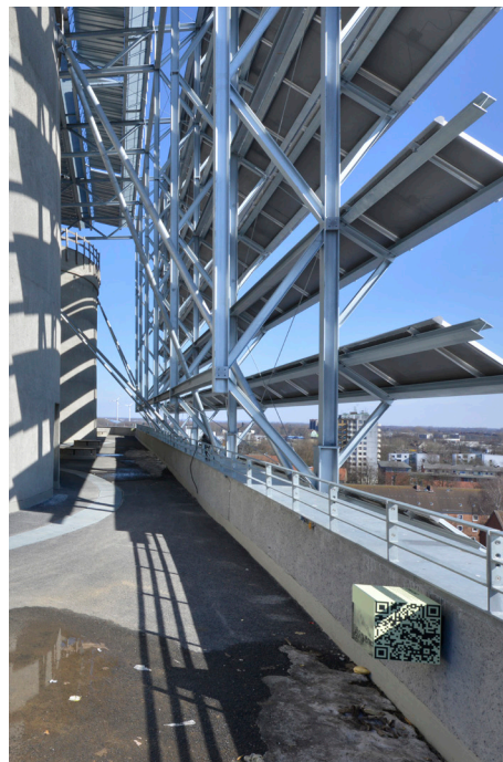
Abb. 8: Photovoltaik-Anlage auf der Südseite
