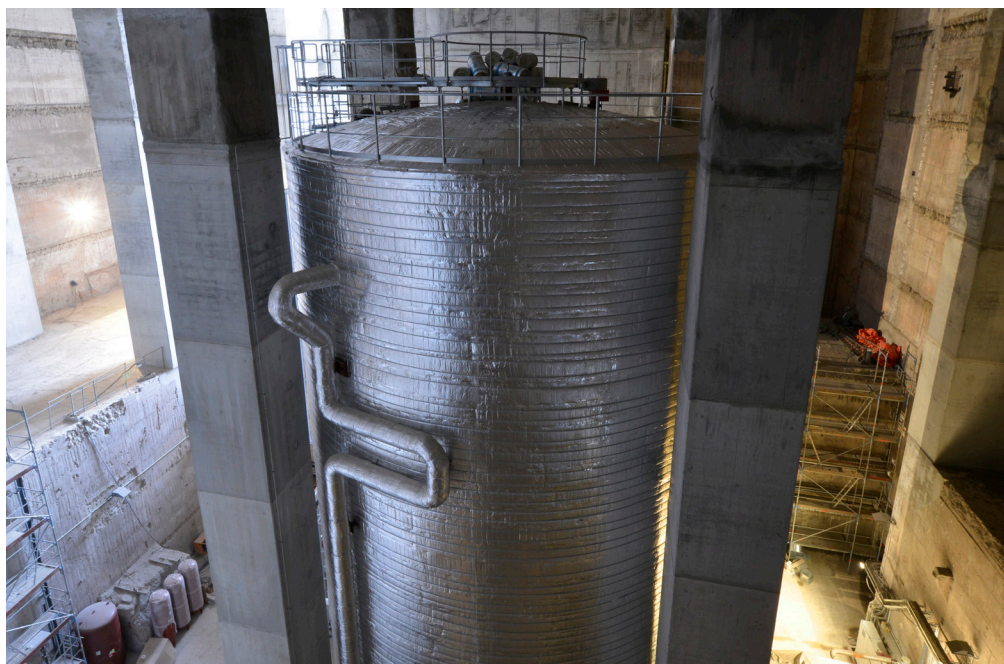
Abb. 11: Der im Bunker installierte Großpufferspeicher kurz nach der Inbetriebnahme
