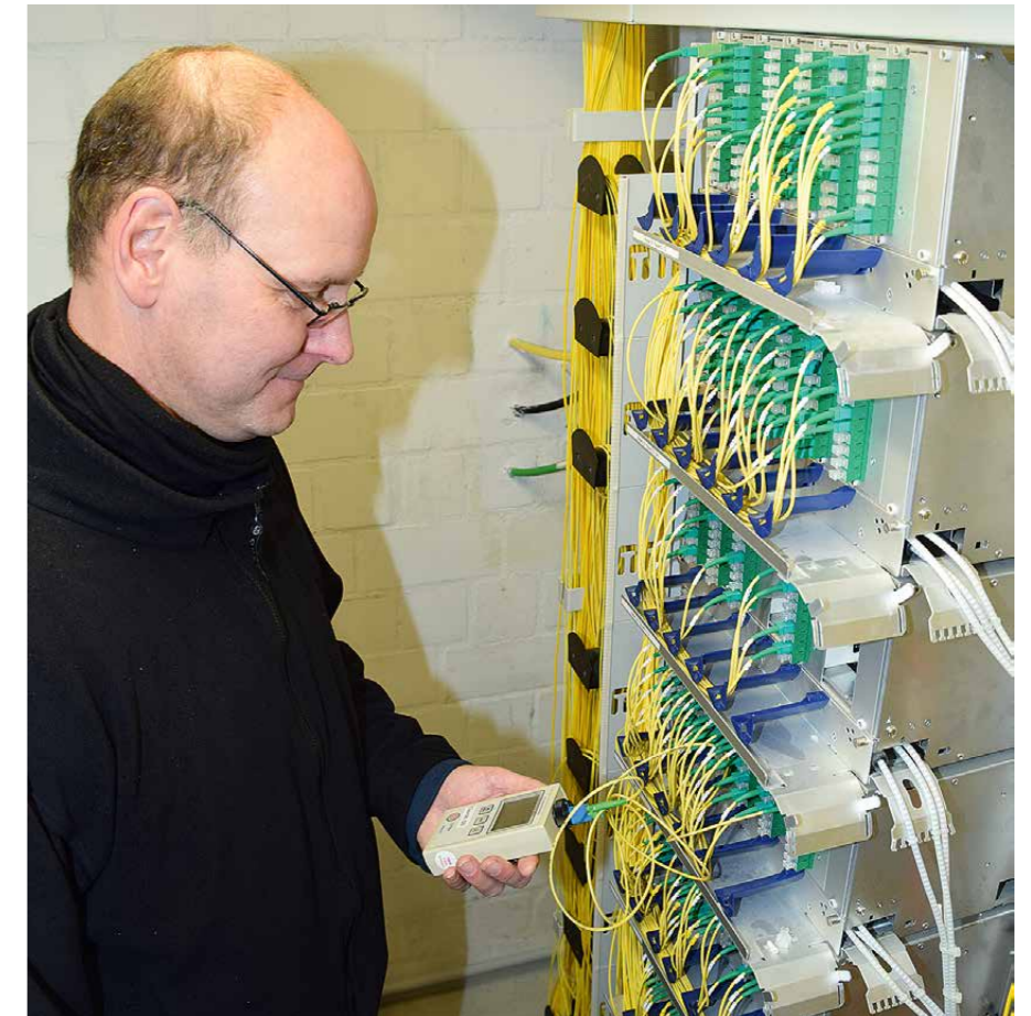
Zentrale für Hamburgs schnellstes Internet ist ein Kellerraum in einem Mehrfamilienhaus in Wandsbek. Bauleiter Christian Günther prüft die Leitungen.
