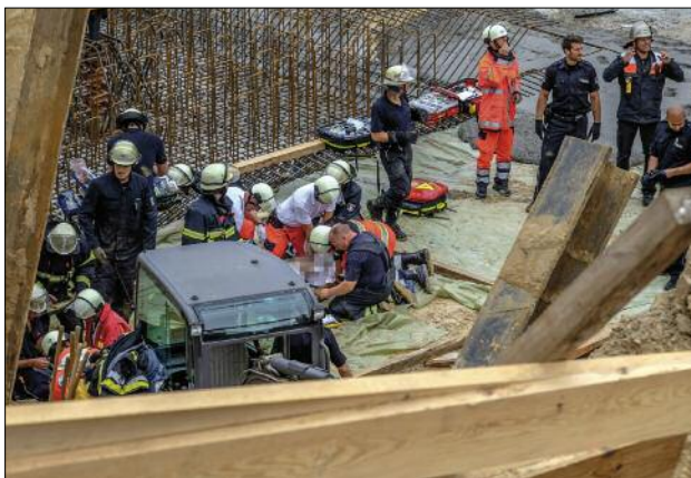
30.07.2014, THV, WINTERHUDE: Zwei Personen bei Arbeiten in Baugrube komplett verschüttet. Personenrettung durch SEG-Höhenrettung mit Baukran. Eine Person unter Reanimationsbedingungen, eine ansprechbar, ins Krankenhaus befördert
