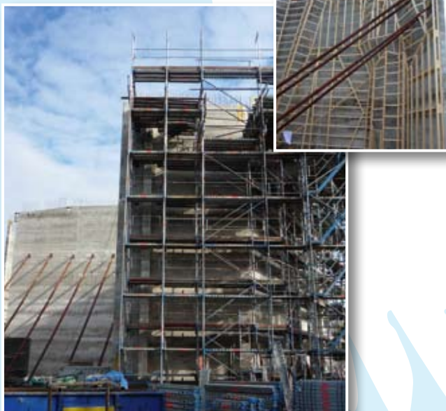
Noch sind die Bauarbeiten in vollem Gang. Die Holzkonstruktion lässt die Form der späteren Kletterwand schon erahnen.
