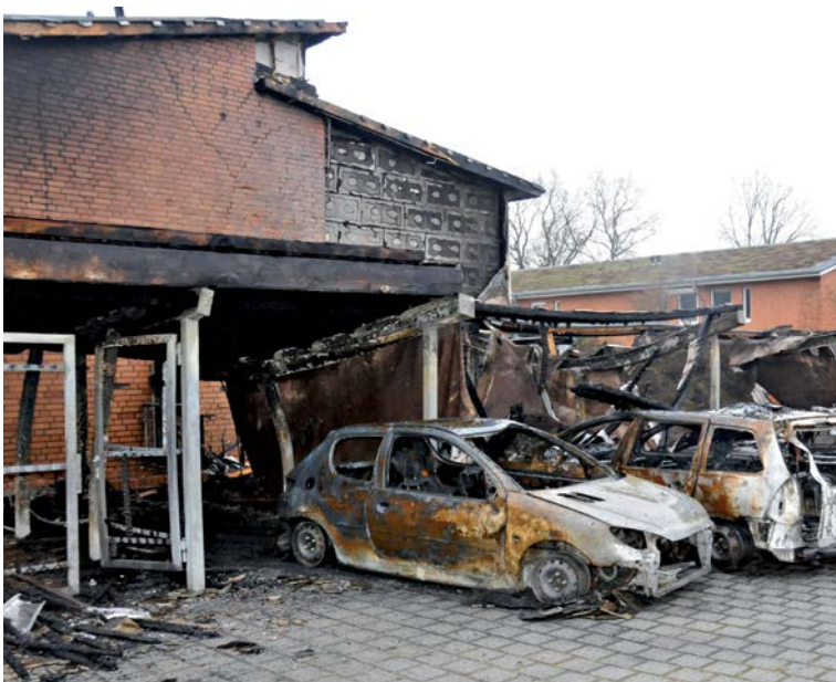
Wohnanlage Norderstedt II Nach zweimaliger Brandstiftung wurden feueranfällige Carports durch Garagen ersetzt.
