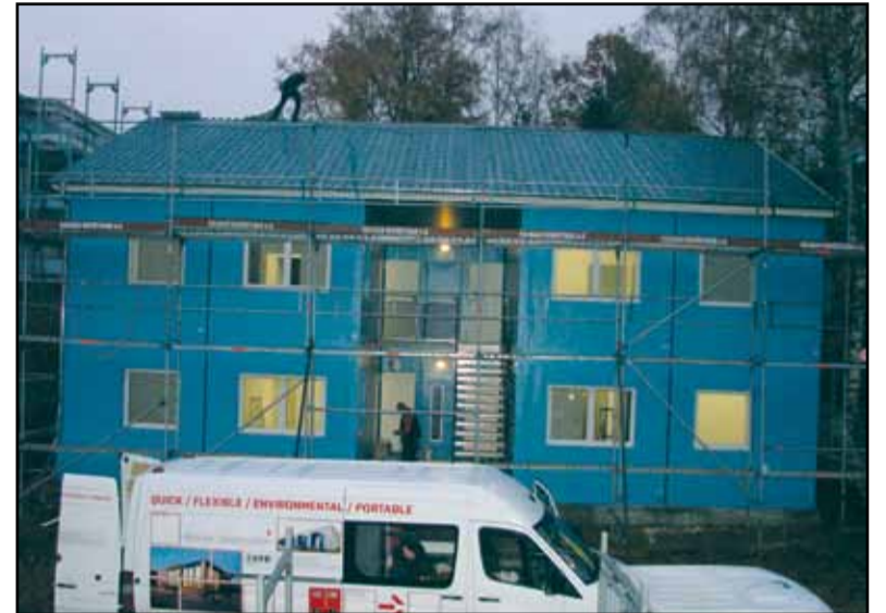
Das Modulhaus mit Satteldach birgt vier Kompartimente, die jeweils zwei Doppelzimmer für minderjährige unbegleitete Flüchtlinge bieten, insgesamt also 16 Plätze, sowie jeweils eine Küche und sanitäre Anlagen. Darüber hinaus gibt es für die Minderjährigen einen Aufenthaltsraum im Obergeschoss. Foto: von Bockel
