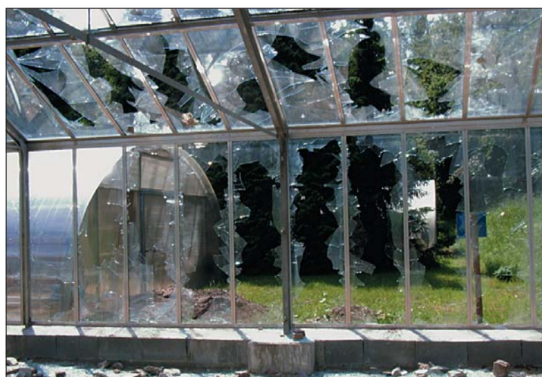
Viel ist nicht vom Gewächshaus übrig geblieben: Insgesamt wurden 74 Scheiben zerstört. Das Folienhaus im Hintergrund wurde ebenfalls beschädigt.
