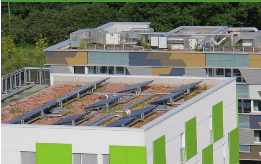
Doppelter Nutzen: bepflanztes Dach mit solarthermischer Anlage.
