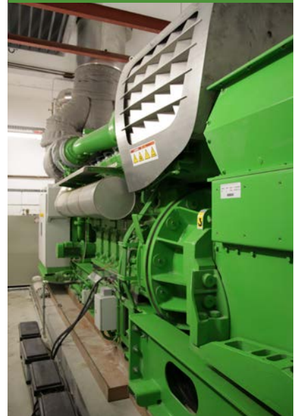
Blockheizkraftwerk – gefördert durch Unternehmen für Ressourcenschutz.
