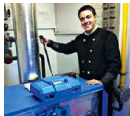
Arbeitsplatz Keller: Lukas Iwesitsch kontrolliert die Heizungstechnik.
