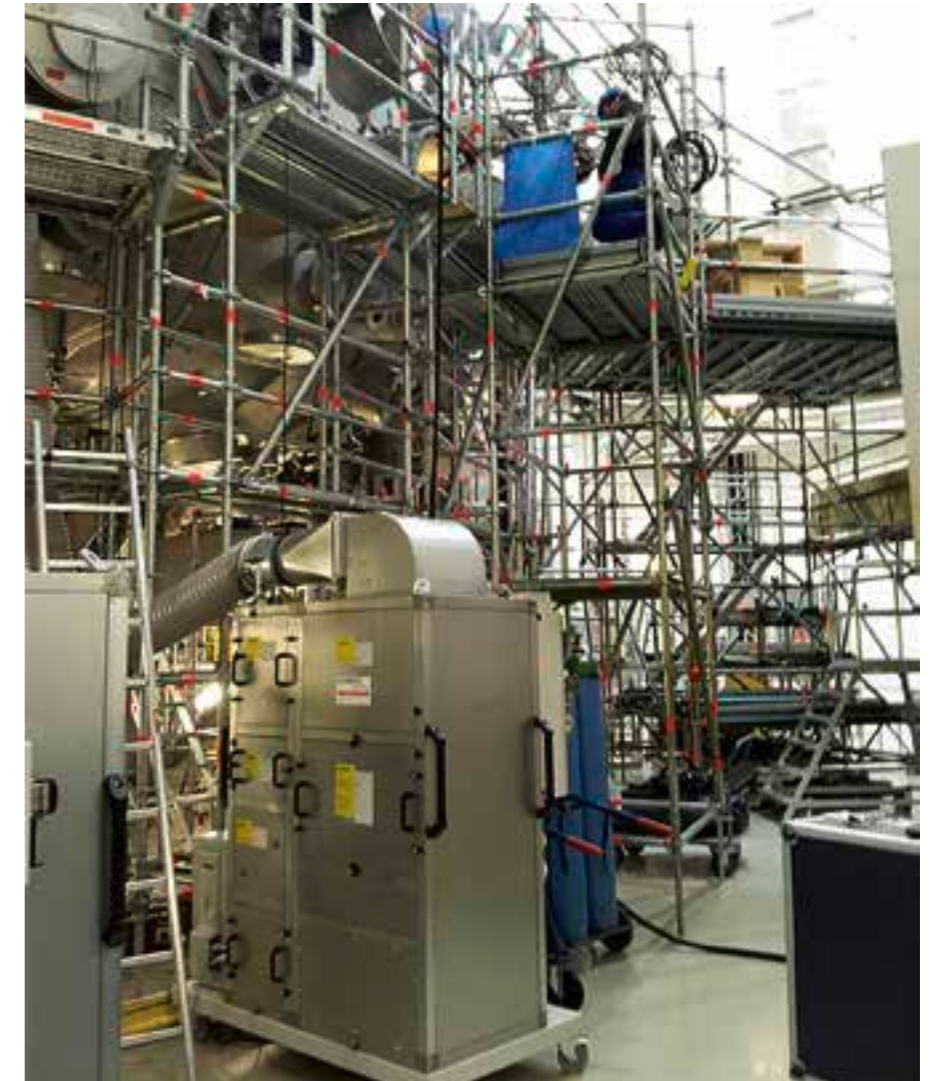
Zum Kernfusionsexperiment Wendelstein 7-X steuerte Hummel insgesamt drei Lüftungs- und Klimaanlage bei (unten im Bild), die für die Montage benötigt wurden.
