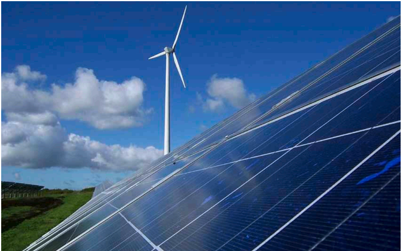
Die SRH betreibt den Ausbau der erneuerbaren Energien seit über zehn Jahren: Fotovoltaik- und Windkraftanlagen in Neu Wulmstorf.
