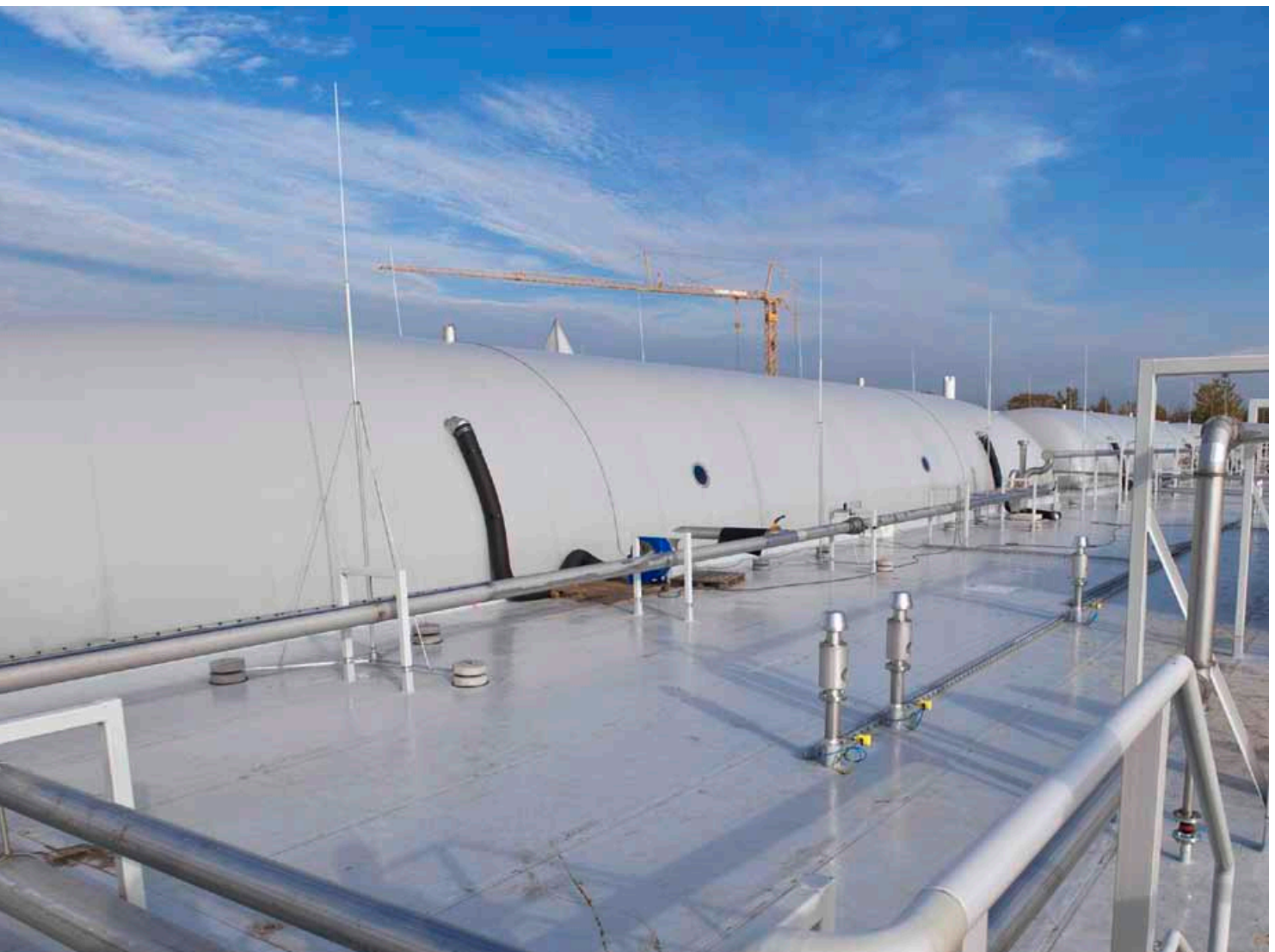
Gasbehälter auf dem Dach des Biogas- und Kompostwerks Bützberg
