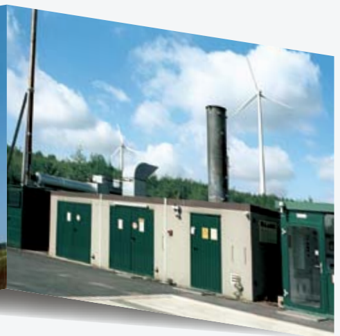
... ein Blockheizkraftwerk, das aus Deponiegas umweltfreundliche Energie erzeugt.
