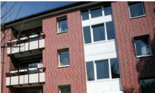
VE 32 nach Fertigstellung der Arbeiten. Mit der weißen Verfugung wurde der verwendete Stein besonders hervorgehoben.
