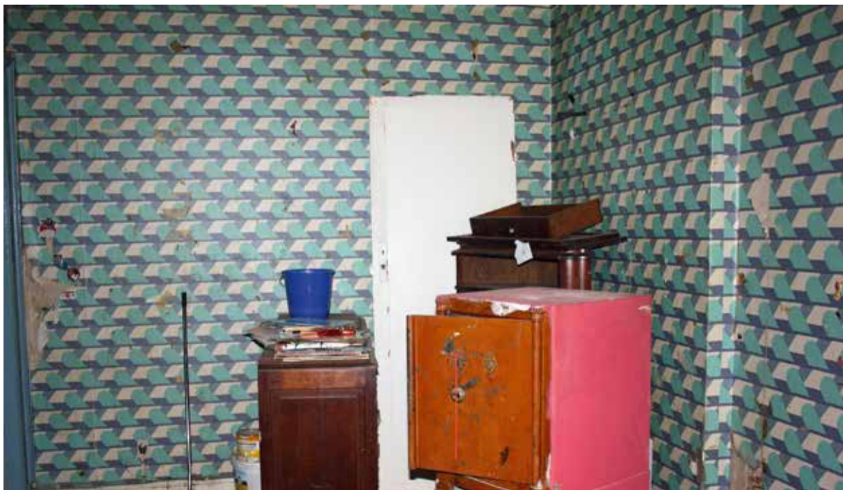
Überbleibsel aus bewohnten Zeiten. Eine der Wohnungen im Jupi-Haus bei Sanierungsbeginn.
