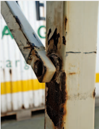
Die Aufhängung der Strebe am Stützbein kann überlastet werden.
