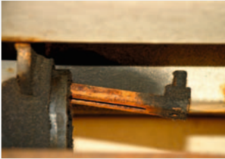
Verbogene Aushaksicherung: Das Gelenkrohr kann aus dem Traglager rutschen.
