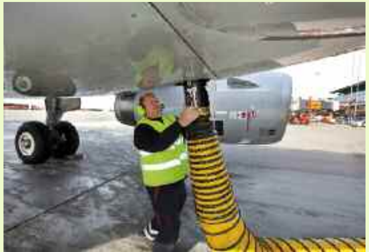
An den Pierpositionen werden die Flugzeuge über das BHKW mit Strom und klimatisierter Luft versorgt
