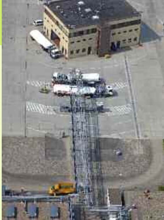
Das zentrale Kerosinlager unterliegt sehr strengen Sicherheitsvorkehrungen
