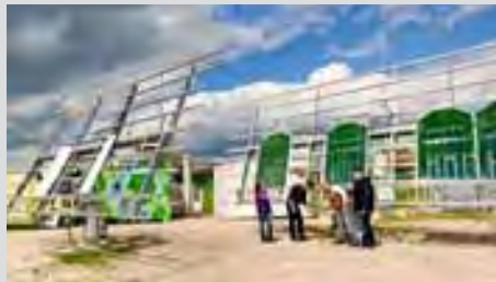
55 Algenanlage Hamburg Reitbrook
