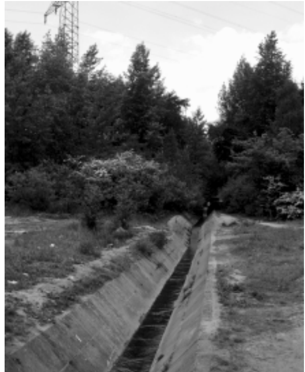
Abb. 70: extremer Gewässerausbau am Schlemmer Bach
