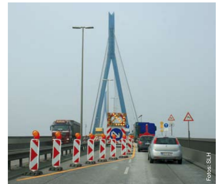
Viele Straßen und Brücken sind dagegen marode
