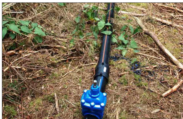
Abb. 6.5.3: Schlauchsystem zur Versickerung von Klarwasser im grundwasserfernen Kiefernwald (E. Eiben)
