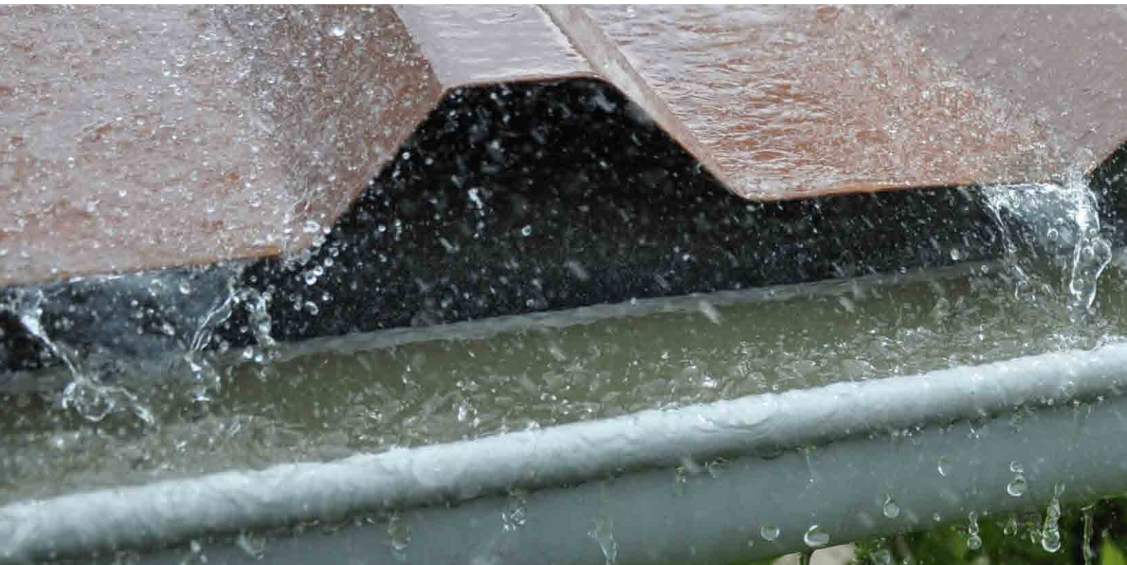
Abb. 5.4.1: Überlauf einer Dachrinne nach einem Starkregenereignis [5].
