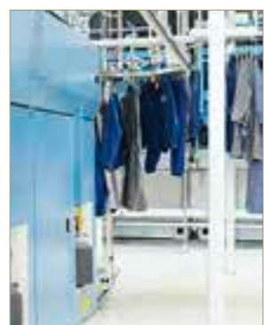
Die Wäsche trocknet im Niedrigtemperaturverfahren.
