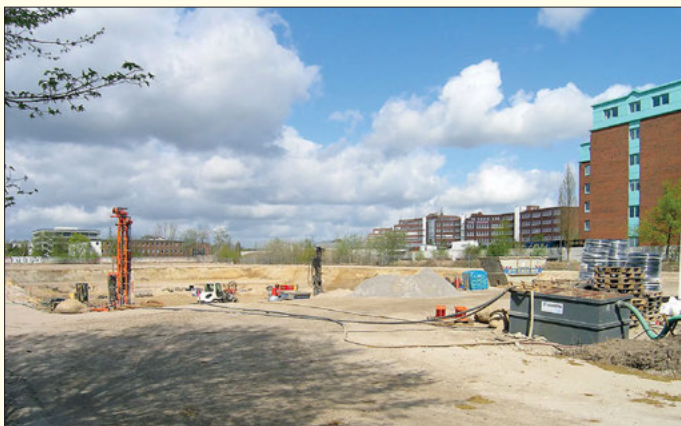
Die Größe der Baugrube am Friedrich-Ebert-Damm 129 lässt die Dimension des Neubaus erahnen. Foto: Thorsten Richter
